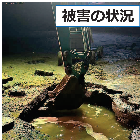
図 200mm鋳鉄管漏水状況 (R6長生広域水道 茂原市茂原地先)
