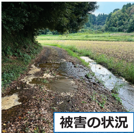
図 150mm塩化ビニル管漏水状況 (R5長生広域水道 一宮町一宮地先)
