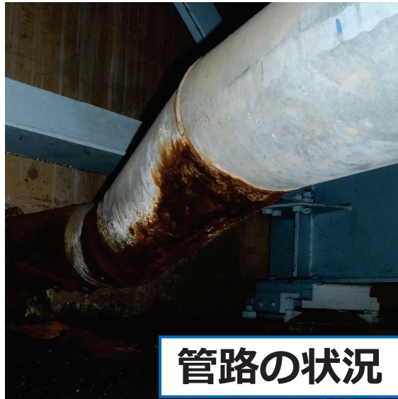
図 200mm鉄管の老朽化状況 (R7長生広域水道 茂原市豊田地先)
