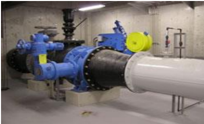
大沢配水池緊急しゃ断弁
