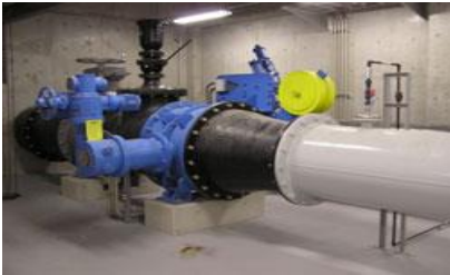
大沢配水池緊急しゃ断弁
