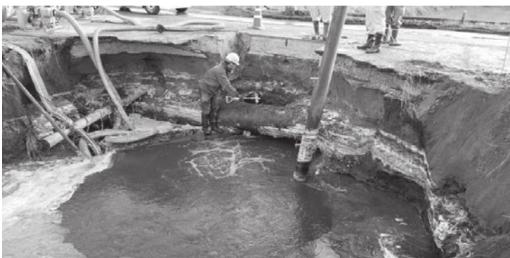
【漏水発生現場（茂原市）令和2年度】
